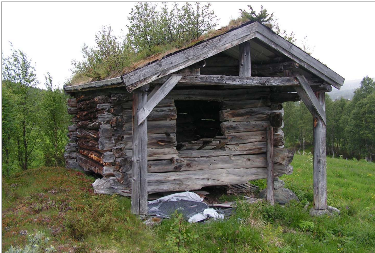
Med utkraga tak fikk man en lessekut som ga ly for regn både under lessearbeid og kafferast og dannet en tørr plass til oppheng av utstyr på vegg. Foto SEE, Rennebu i Sør-Trøndelag.
