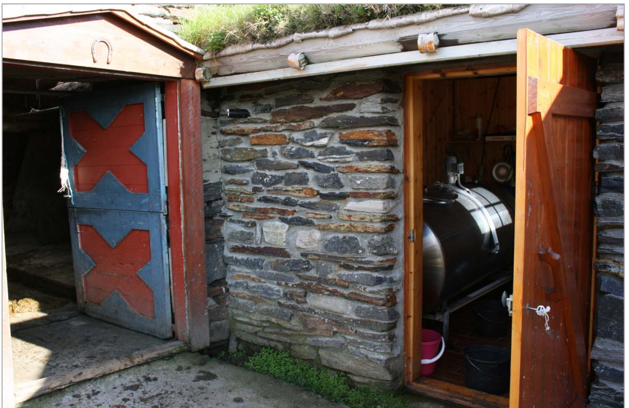
Det gamle steinfjøset har fått et påbygg som huser melketank og melkeutstyr. Foto KJM, Folldal i Hedmark.
