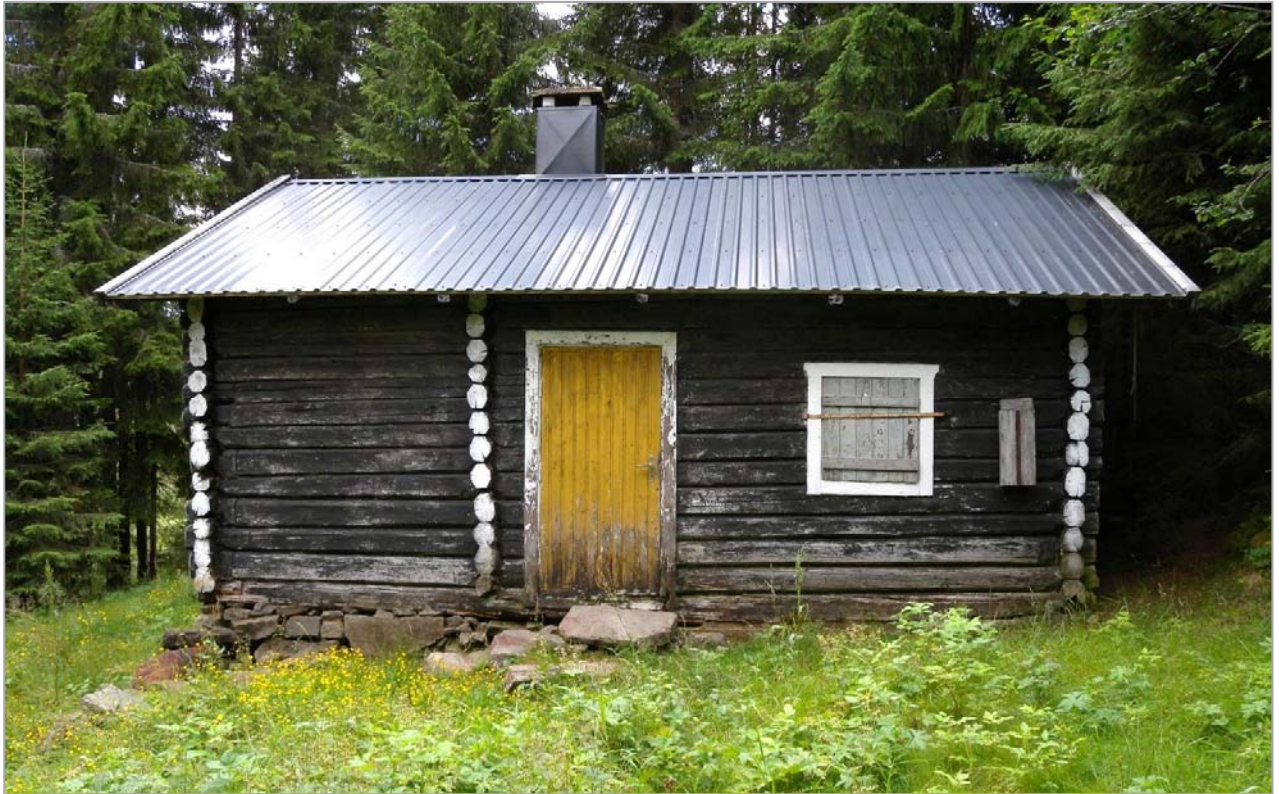
Metalltak har vært redningen for mange slitne hus, men det er bare førstehjelp. Dessverre ser vi en del som aldri kom lenger enn til taket. Men for denne seterstua er det fortsatt håp. Foto GHS, Elverum i Hedmark.
