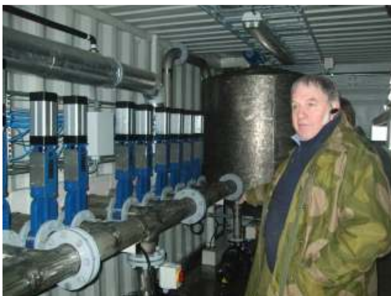
Figur 3. Morten Holvik ved pumpestokken i biogassanlegget. Oppvarming av substratet i råtnetankene skjer ved hjelp av ei kappe med varmt vann som omslutter en del av dette røret. Inn- og utpumping styres av ventilene over røret. Blandetanken i bakgrunnen. Foto: Anne-Kristin Løes.
