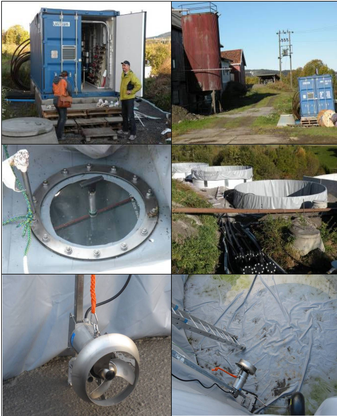
Bilder fra anlegget på Holum. Øverst til venstre: Liv Birkeland og Jens Måge på vei til å inspisere teknikk containeren. Øverst til høyre: Lagringstank for matavfall. Midten, til venstre: Nærbilde av vindu med innvendig skrape i PVC duken, til inspeksjon av forholdene i reaktoren. Midten, til høyre: Tre reaktortanker, alle kledd med PVC duker. Bak og lengst høyre sees sluttlageret i betong; fortanken ligger rett til høyre utenfor bildet. Merk i forkant av bildet gjødselrør med stakekum, under ligger varmerør isolert. Nederst i bildet til høyre inspeksjonskum for kondensfellen. Drenering fra fyllmasse, og fra reaktorene munner ut i en liknende kum plassert på laveste nivå i anlegget og føres videre til en samlegrøft. Foto: Ketil Valde. Nederst til venstre: Propellmikseren er montert og venter på noe å arbeide med. Gjødselelvået er stigende, og gassproduksjonen allerede synlig som bobler i den brune massen. Nederst til høyre: Tom reaktor sett rett ovenfra, med ferdig montert mikser. Merk dukens utforming i bunnen av tanken. Foto: Kristin Sørheim.
