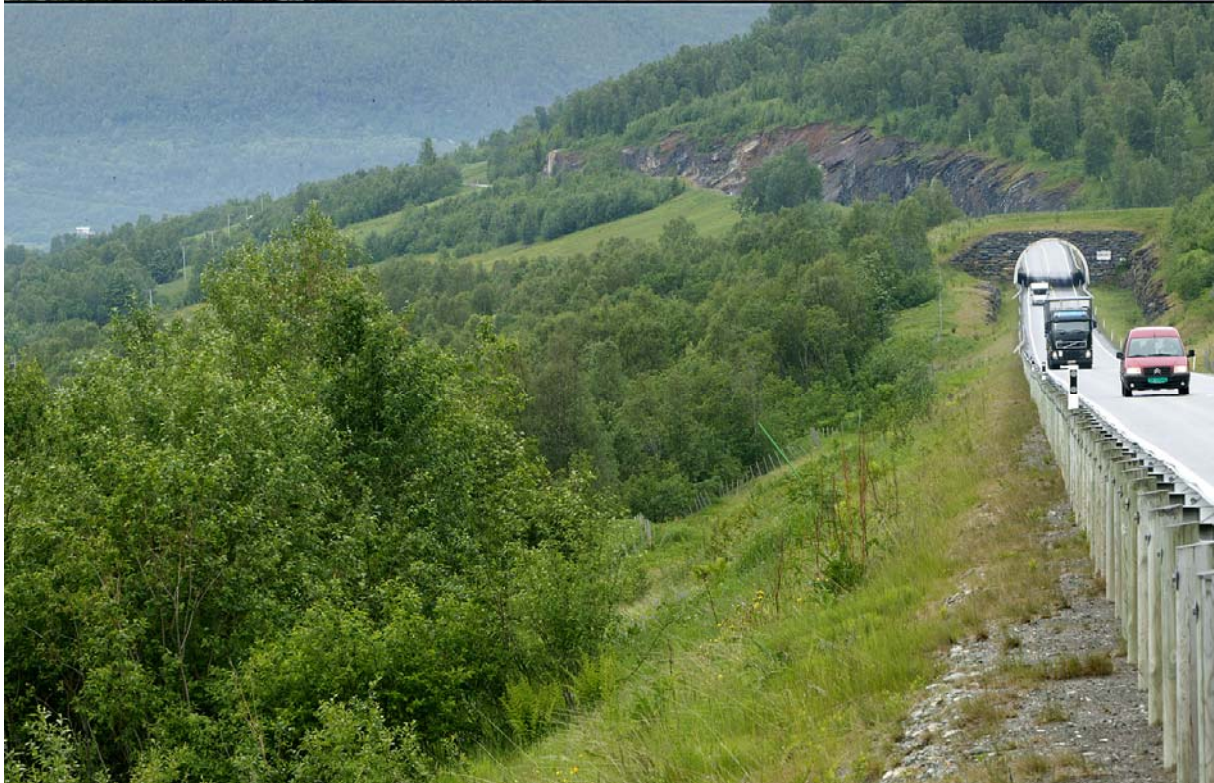
Bilde 14. Bildepar med anleggsarbeid (2000) og ferdigstilt vei (2006). Under anleggsperioden til større veianlegg blir det i 3Q ofte tolket ut mer nedbyggingsareal enn det i realiteten blir når veien er ferdig. Øverste bilde viser en jordkant langs veien som i 3Q ville blitt tolket som nedbyggingsareal (kart 19), mens den grasdekte kanten i 2. omdrev blir tolket som villeng. Det gjør at det i 3Q vil se ut som et nedbygd areal kan gå over til villeng o.a. Etablering av slike nye hovedveier gjør forøvrig at mindre rester av jordbruksareal langs veien tas ut av drift, fordi de er blitt vanskelig tilgjengelige. Bildet er fra Troms.
