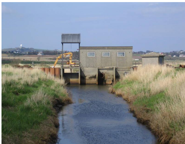
Figur 2. Pumpestasjon i Skas-Heigre-kanalen. Foto: J. Deelstra, Bioforsk.
