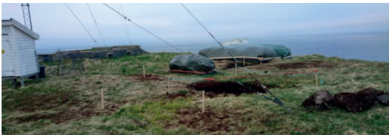
Mellomlager av oppgravde dieselholdige masser. Foto: Rambøll
