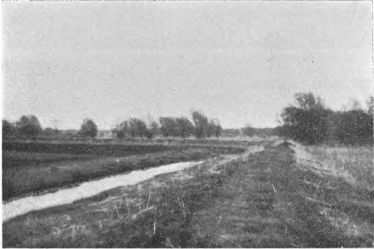
Fra Little Cicero Drainage Project, Onondaja County, New York State. Et ca. 140 acres stort myrområde som tørrlegges ved hjelp av et pumpeverk. Bildet viser avledningsgrøft med tilhørende demning. (10/5—51).
