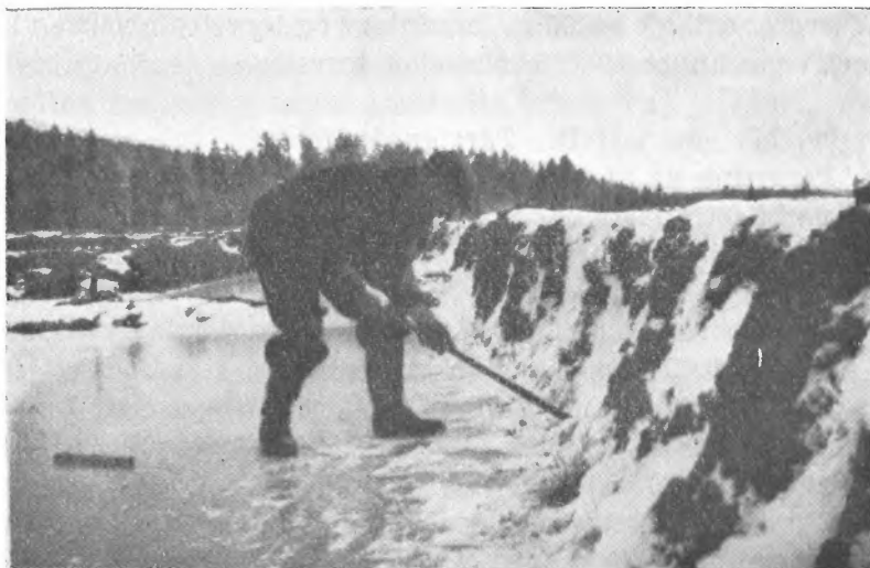
Forsøk med planering av «torvpaller» med grøftedynamitt på Gårdsmyra i Våler. Ladningen foretas. (Fot. O. L.)
