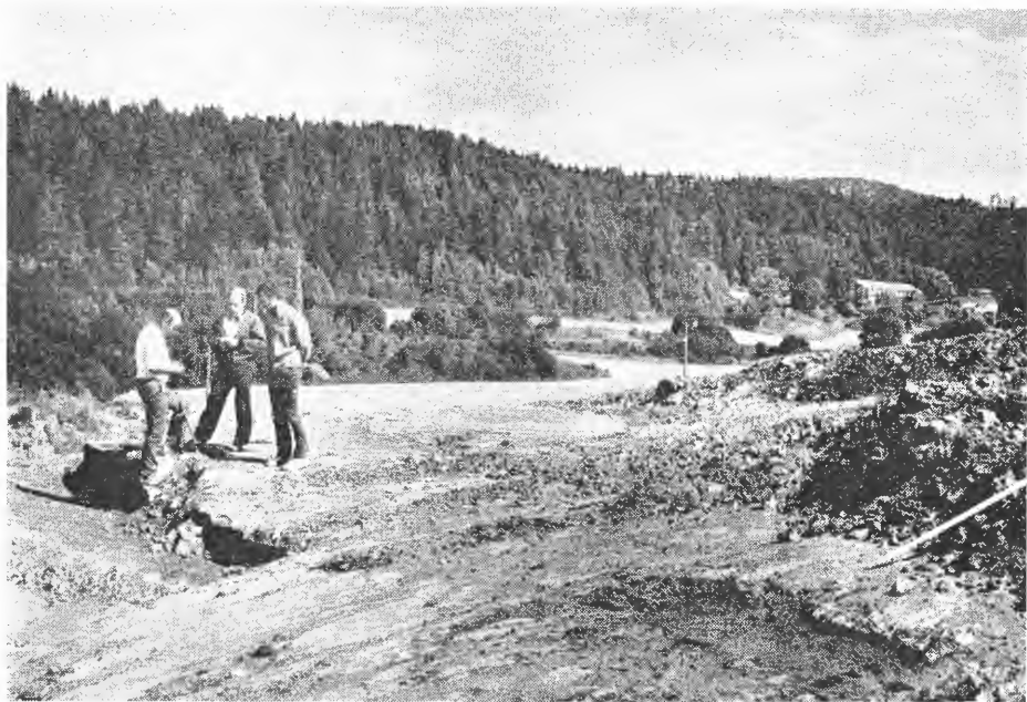
Fig. 1. I forgrunnen til venstre avskrapet fjelloverflate som seinere vil bli påfylt jordmasse. Omtrent samme form på fjelloverflaten her som på det ferdig påfylte arealet. 27.VIII. 81.
