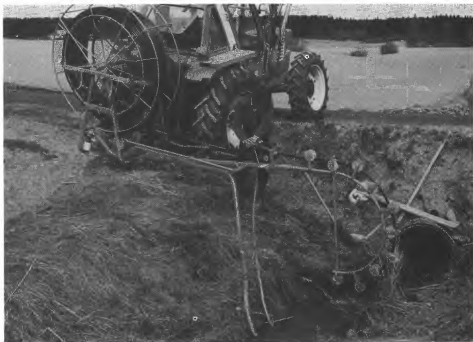
Spyleutstyret i bruk ved spyling av grøft som munner ut i åpen kanal. Ved spyling fra åpen kanal blir kostnadene ved leiespyling under en krone pr. m grøft.
