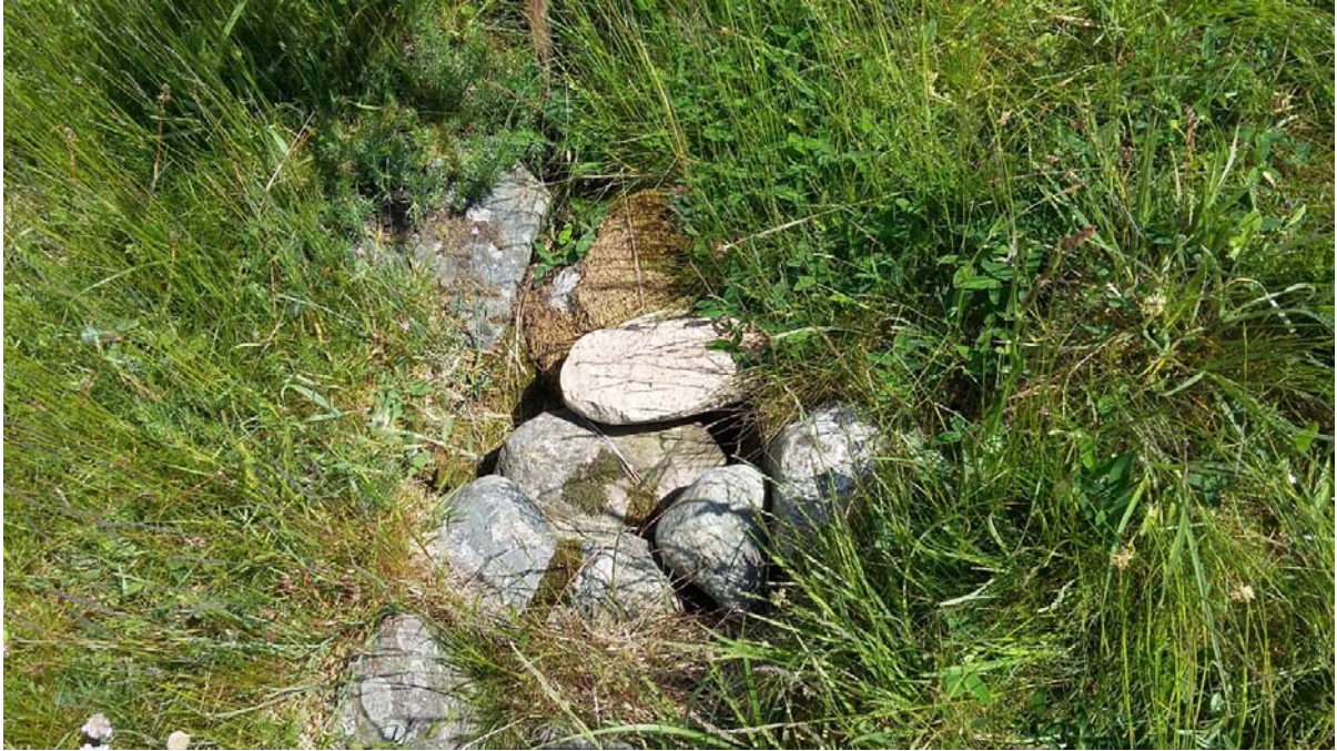
Figur 9. Naturbeitet er drenert med gamle steinsatte grøfter. Foto ES 06.06.2017
