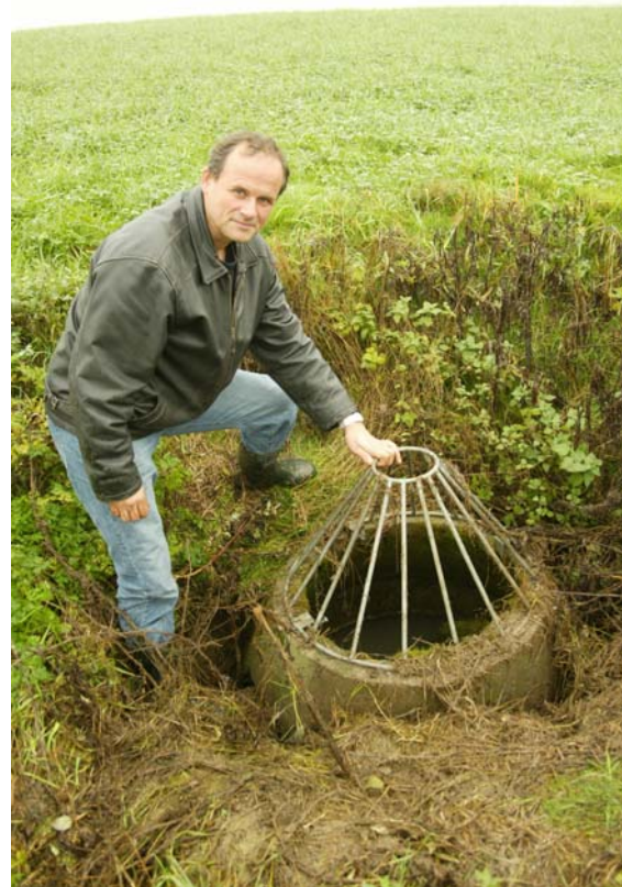
Figur 2. Partikler fra overflateavrenningen fra jordbruksarealene går rett i kummen. I tillegg er det vanlig med erosjon rundt kummen. Forurensingene føres rett i bekken. Foto: Karl Erik Berge
