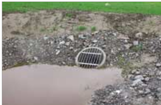
Det er viktig å sikre innløpet dersom bekken ledes videre inn i et lukkingsanlegg, slik det er gjort på Åstorp. Foto: A. Hauge
