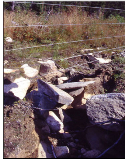
Tetting av grøft med stein (foto: R. Bjøru). Tightening a ditch with stones.
