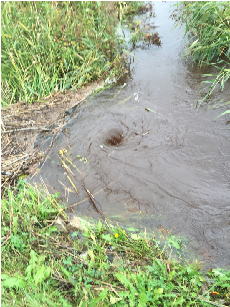
Bilde 2: Underdimensjonert stikkrenne får vannstanden til å stige i kanalen etter kraftig nedbør.
