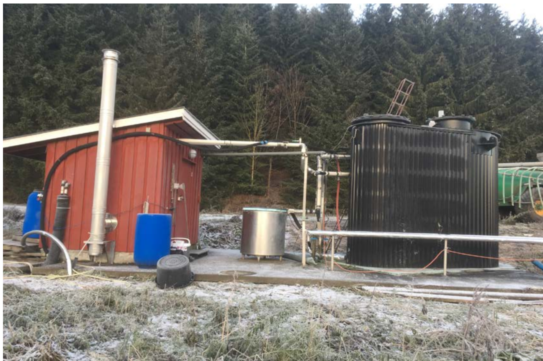
Figur 1. Fra høyre mot venstre: biogass reaktorhus med integrerte varmevekslere, returkum i rustfritt stål, bod for instrumentering og varmtvannskjel.
