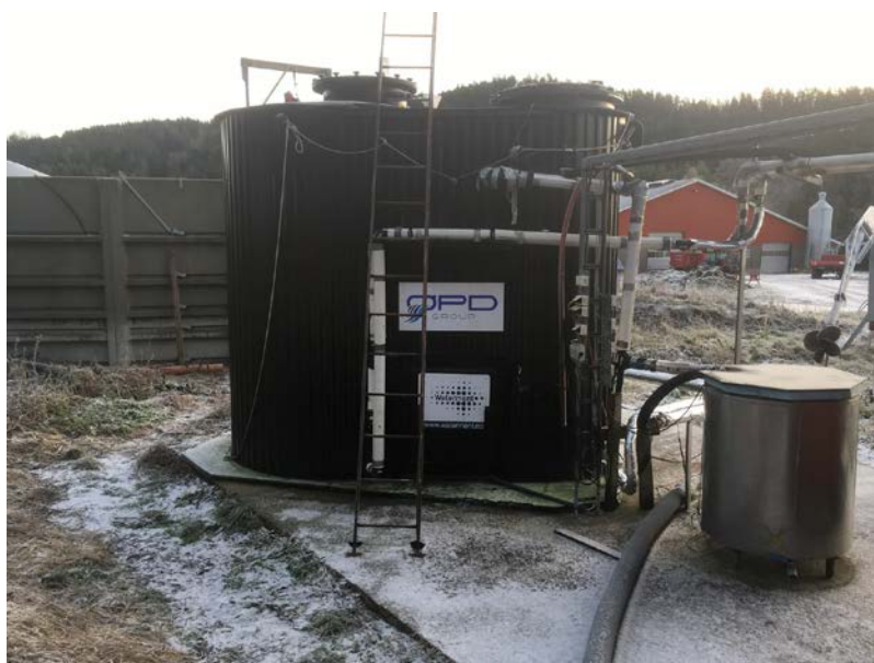
Figur 6. Biogass reaktorhus med gjødsellager i bakkant og pumpekum for retur i rustfritt stål til høyre.
