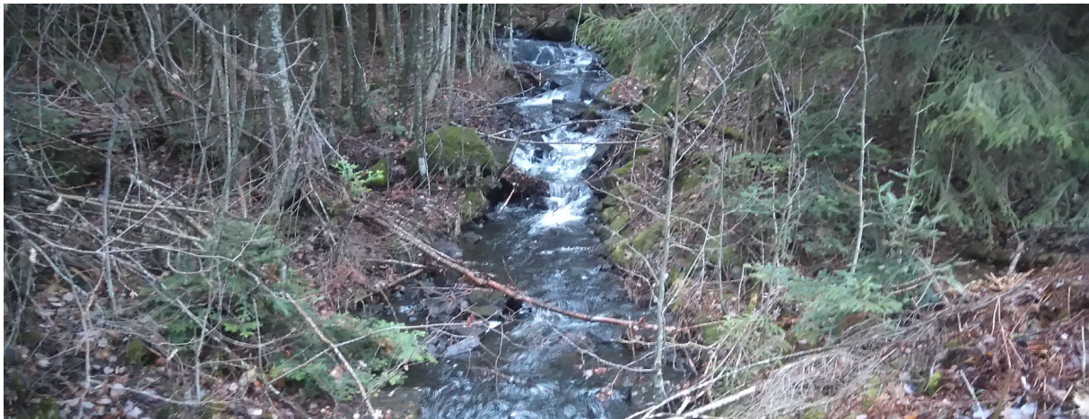
Figur 11. Stasjonen DAM nedstrøms der Damtjernbekken føres under Fv285 i kulvert og oppstrøms Fjulsrudveien (Foto: Roger Roseth, NIBIO).
