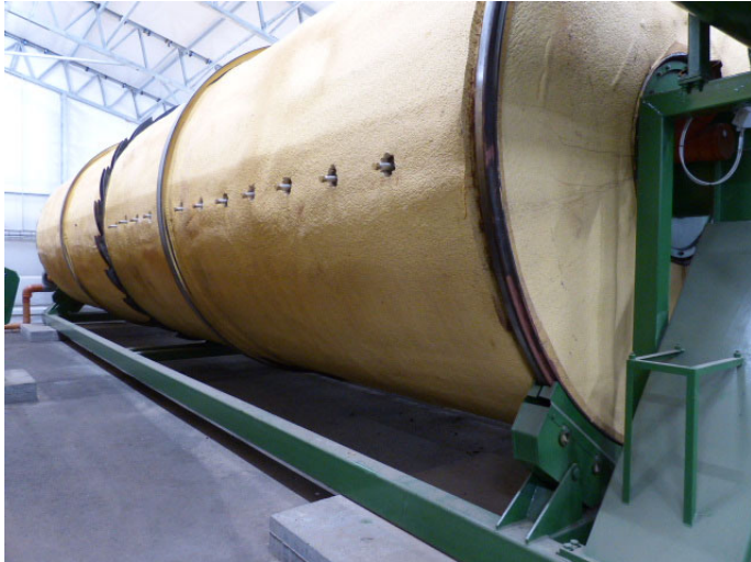
Figur 13. Jordfabrikkens komposteringsreaktor med automatisert omdreining
