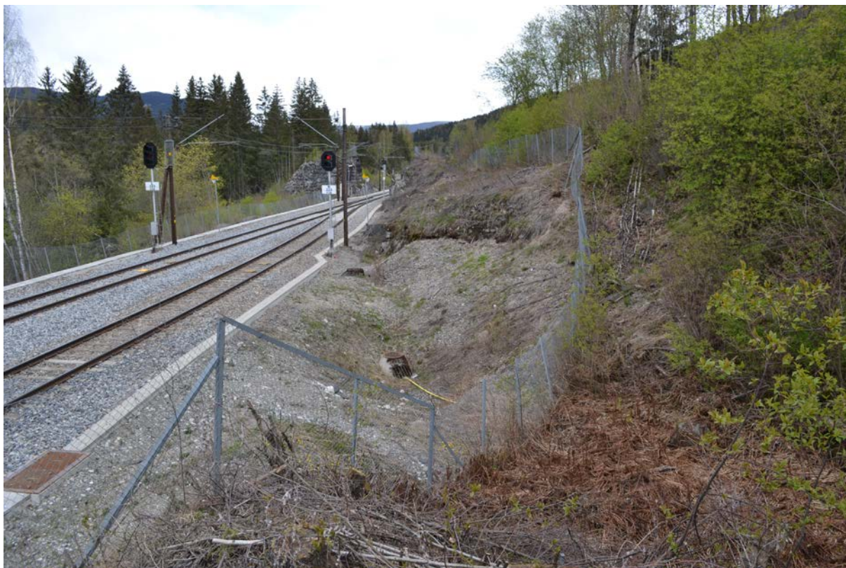
Figur 10. Kum for gjennomføring av vann under jernbanelinjen ved kryssingsspor nord for Fåberg.
