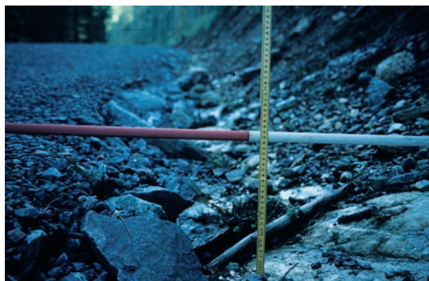
Figur 11. Grunn grøft på traktorveg. Sprengning vil være nødvendig for å oppfylle dybdekravet.
