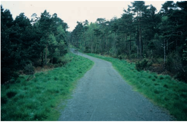
Figur 12. Graset gror inn i kjørebanelen på bilvegen.
