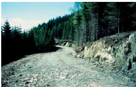
Bilde 2. Kombinerte vegger for skogbruk og friluftsliv har vist seg å være en god løsning i bynære skogområder. Bildet viser en kombinert bilveg under anlegg i bratt terreng, der terrengforholdene setter klare begrensninger for vegens utforming. Frotveit-Riple, Bergen. Foto: Hans Nyeggen
