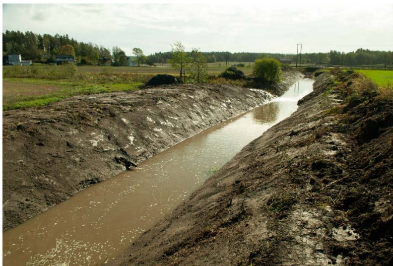
Figur 4.2. Elveløpet til Veidalselva ble utvidet sensommer/høst 2018. Bildet er tatt i september 2018. Foto: Ruben A. Pettersen.
