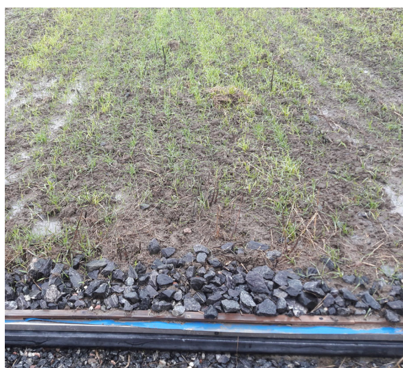
Figur 1.3. Restaurering av oppsamling for overflatevann. Et smalt oppsamlingsområde for overflatevann reduserer fortykning direkte fra regnvann. Redusert risiko for jordrotter i grus og med dyrking helt frem til grusen. Høsten 2020.
