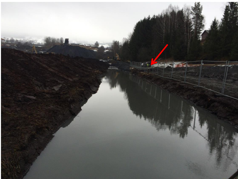
Figur 5 viser en utgravd sjakt langs ytterkanten av myrområdet. Bildet indikerer at grunnvannet står høyt i terrenget, ca. 1 m under overflaten. Den røde pilen peker på brønn 6, en fjellbrønn med filter fra 9,5 m – 14 m dyp, målt fra overflaten (ca. kote 208). Vann-nivået i brønnen er lavere enn vann-nivået i sjakten. Bilde er tatt den 4. mars 2014.
