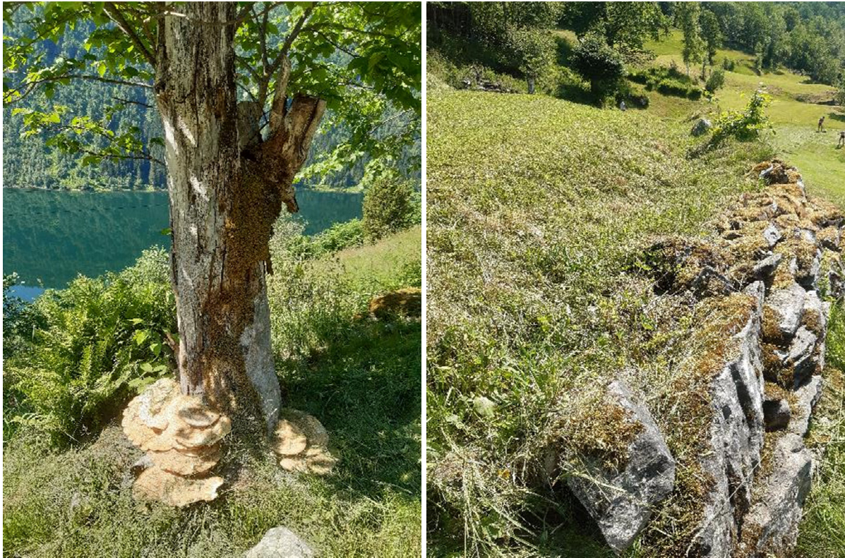
Figur 20. T.v. styvingstre av alm med skjellkjuke Polyporus squamosus . T.h. mur som har begynt å sige ut ved at det har danna seg et søkk på innsida. Foto ES 26.06.2020
