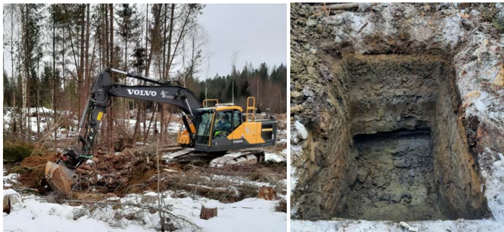
Figur 7. Gravemaskin ble brukt for å grave kontrollpunkter langs ERT-linjene. Her ble tekstur og dybde til fjell målt inn og relatert til ERT målingene.
