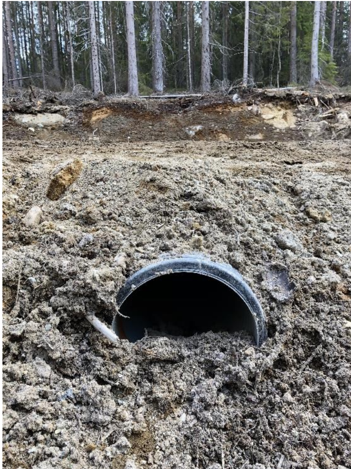
Figur 26. Stikkrenner er ekstremt viktig. Både med tanke på dimensjonering, antall og plassering. Tette eller defekte rør kan få enorme konsekvenser for områdene der vannet tar veien. Dette er et eksempel på dårlig utført arbeid ved legging av stikkrenna. Bilde: Martin Bråthen, Skogkurs.
