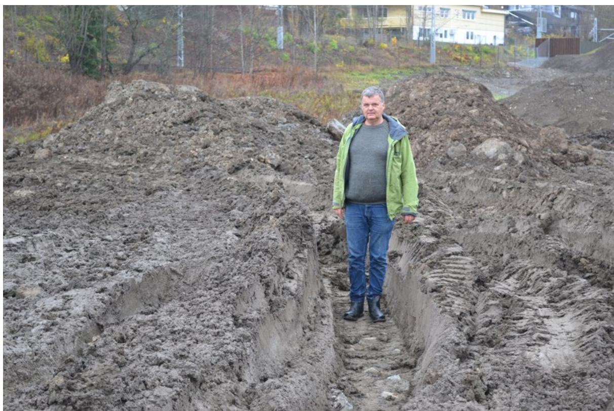
Figur 12 Siltig mellomleire er plastisk i svært fuktig tilstand og har da svært liten bæreevne for anleggsmaskiner (Foto: Trond Knapp Haraldsen)
