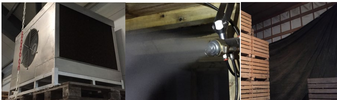
Bilde 7. Ulike måter å oppfukke lagerluft: Gjennom fordampning fra membraner med vifte (t.v.), Tåke/dysespredning (midten), og oppfukking av store duker hengende på vegg (t.h.). (Fotos: Erlend Indergård)
