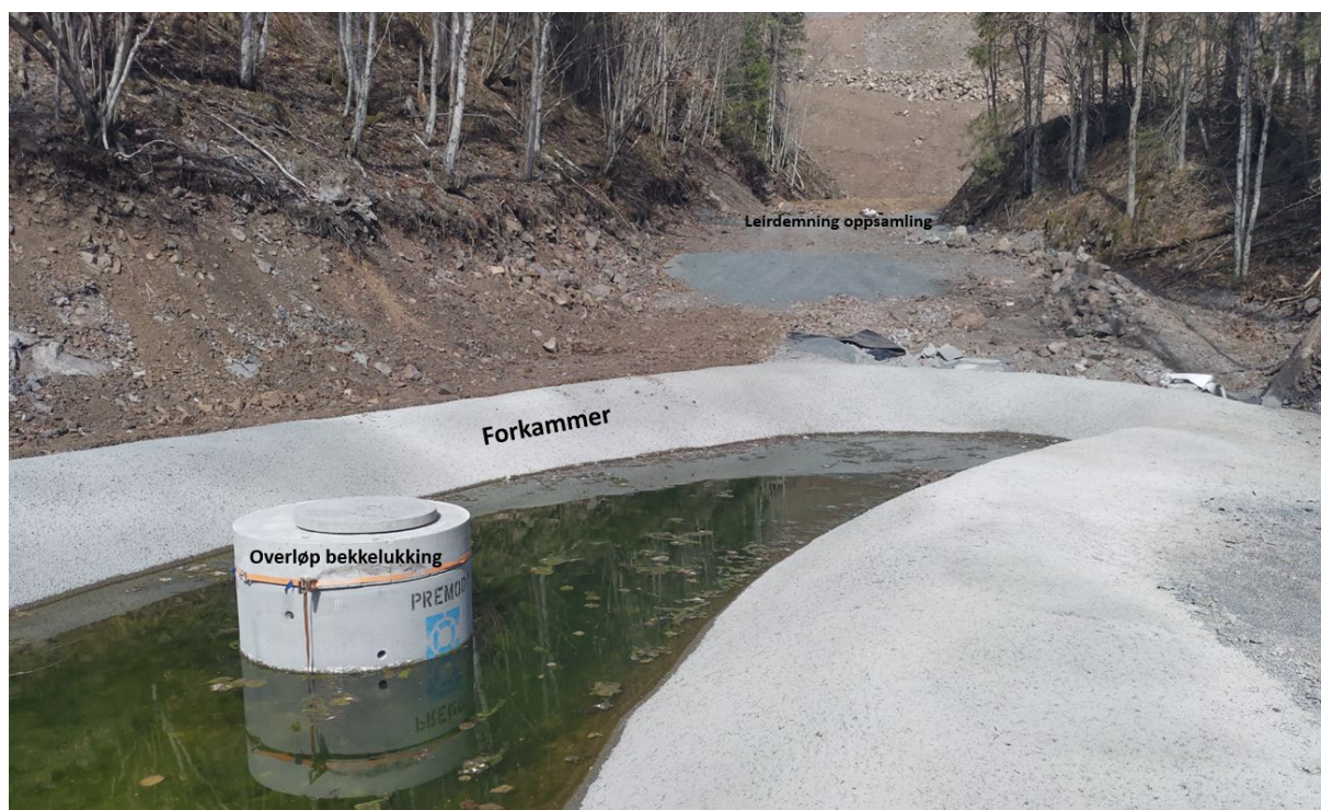
Figur 3. Forkammer med regulert overløp til bekkelukking. Viser leirdam for oppsamling av avrenning fra steinfylling.
