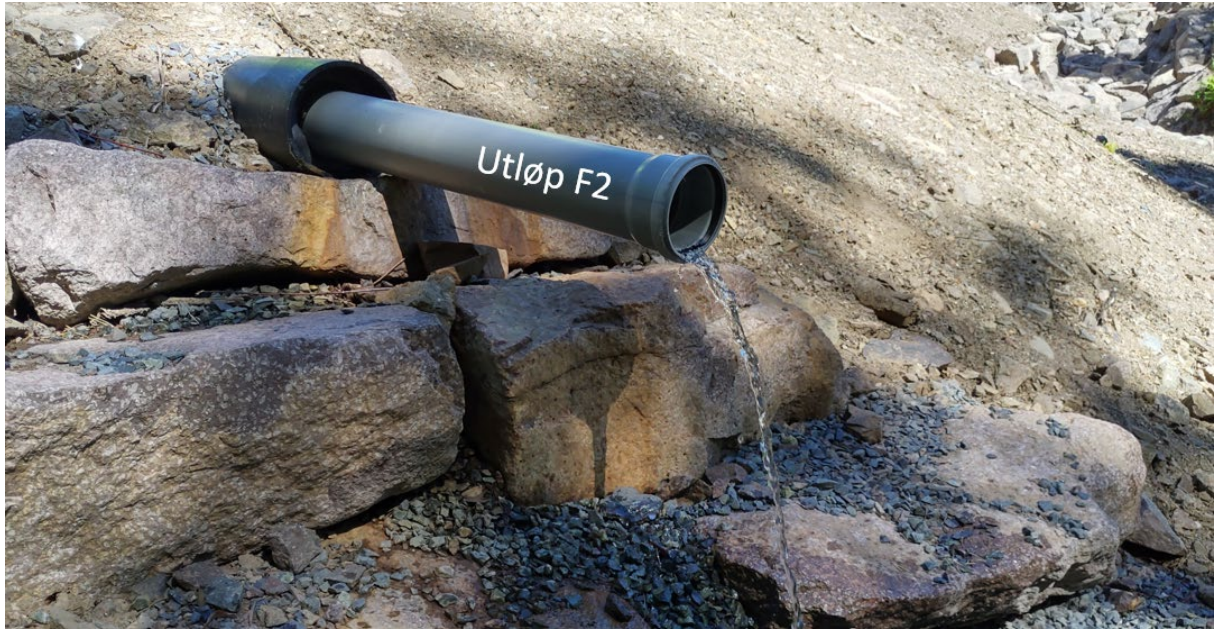
Figur 10. Utløpsrør med rensset vann fra nedre filter (F2) i juni 2022.
