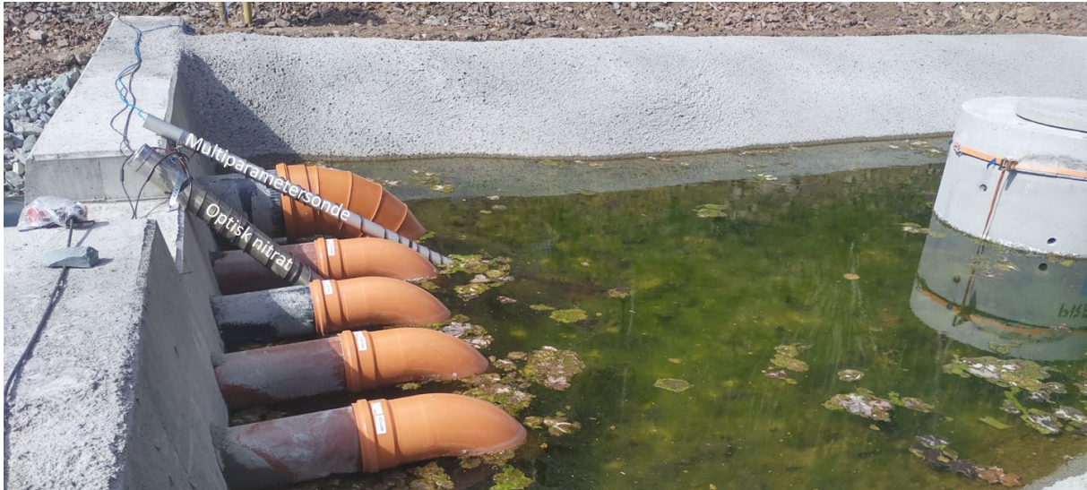
Figur 4. Utløpet av forkammer (INN) med 5 dykkede overløpsrør videre til rensedam. Automatiske målinger av optisk nitrat, turbiditet, pH, ledningsevne, oksygen, redoks, vanntemperatur og vannhøyde hvert 30. minutt.
