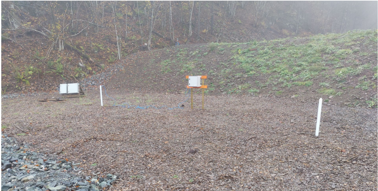
Figur 18. Loggerskap for målesonder F1 INN lengst til venstre. Loggeren i midten styrer multiparametermålingene i grunnvannsrøret i mettet sone av filteret i avstand 5 m fra innløpskum. Målingene kan alternere mellom grunnvannsrørene i avstand 5 og 15 m fra innløp.
