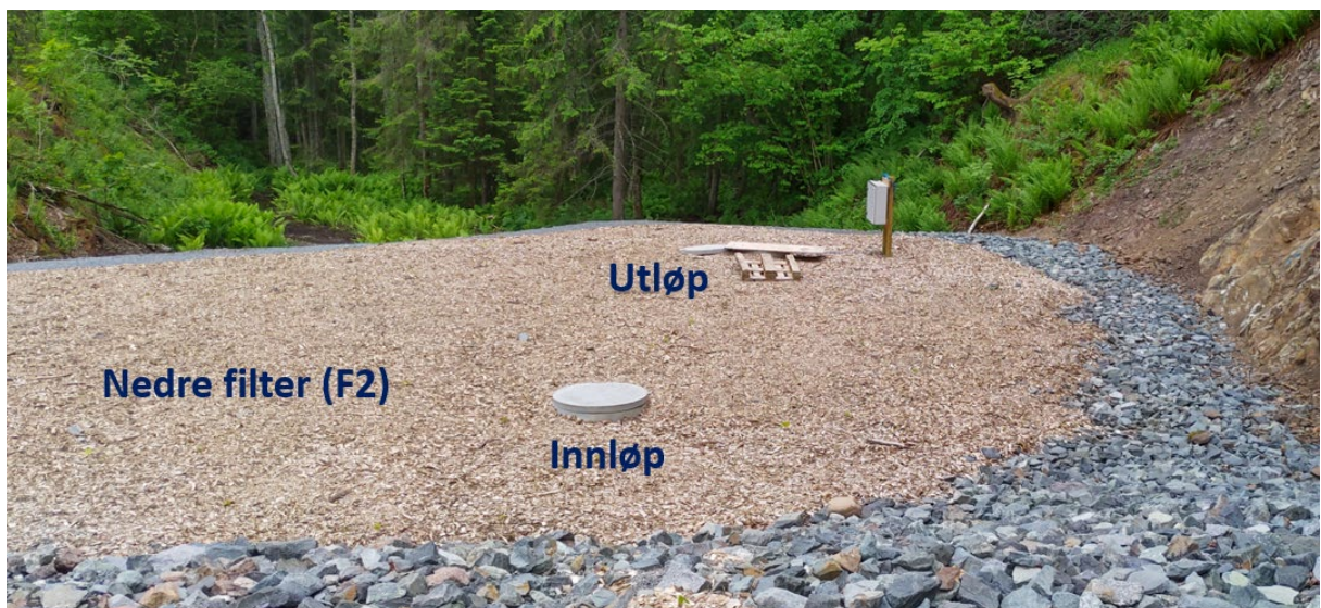
Figur 7. Nedre nitrogenfilter (F2) med innløps- og utløpskum. Automatisk overvåking av vannkvalitet i utløpskum.
