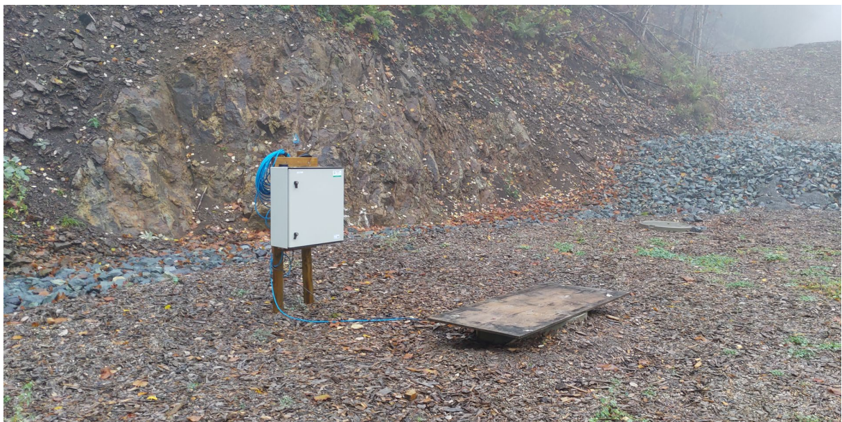
Figur 17. Loggerskap for målesonder ved utløpskum til filter F2 (F2 UT).
