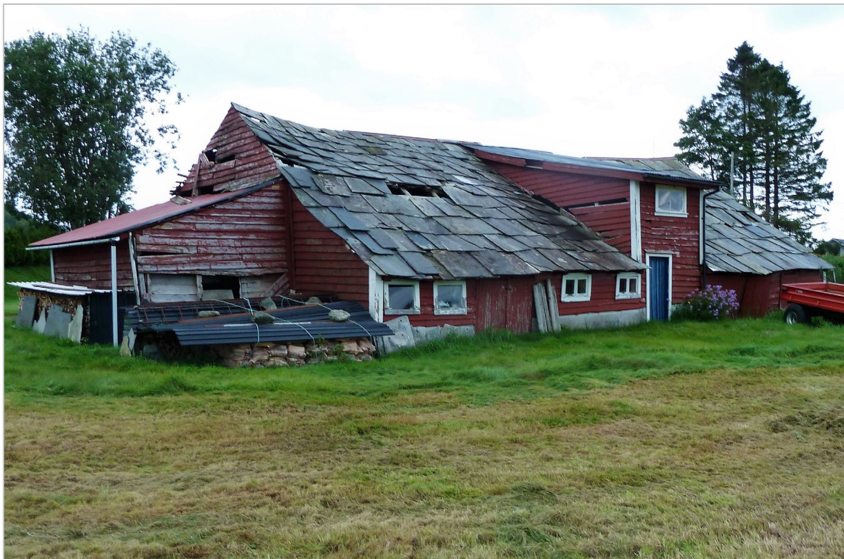
Ti år etter var slitasjen påtagelig på alle deler av huset. 2016. Foto: Jan Reyer Elders.
