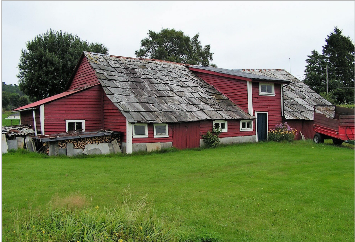
Forfall. Enhetslåven med stort tungt tak av rasteheller så brukbar og nokså imponerende ut i 2006. Hordaland. Foto: Frode Bentzen.
