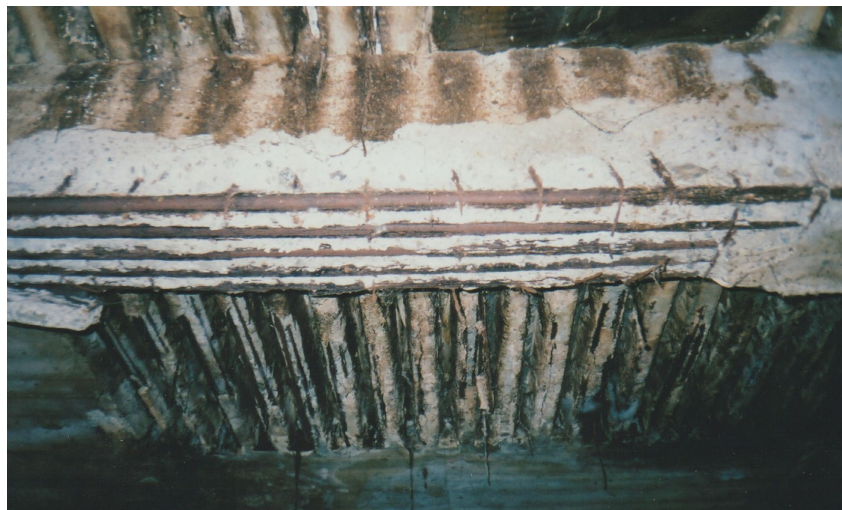
Bilde 2 Betongoverdekningen på dragerens underside er sprengt vekk. Skadeomfanget er størst der det ligger drenerende golv over drageren. Det samme har skjedd med betongspalteplanken som ligger oppå drageren. Foto: Per Olav Skjølberg
