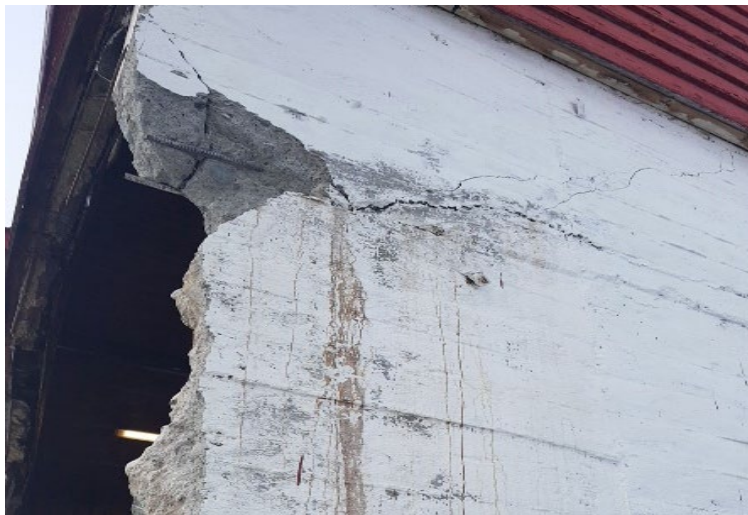
Bilde 1: Bruddflate mot gavlvegg som er presset ut. Normalt vil dekket fram til første drager også falle ned samtidig som gavlveggen ryker. Foto: Jon Gisle Vikan
