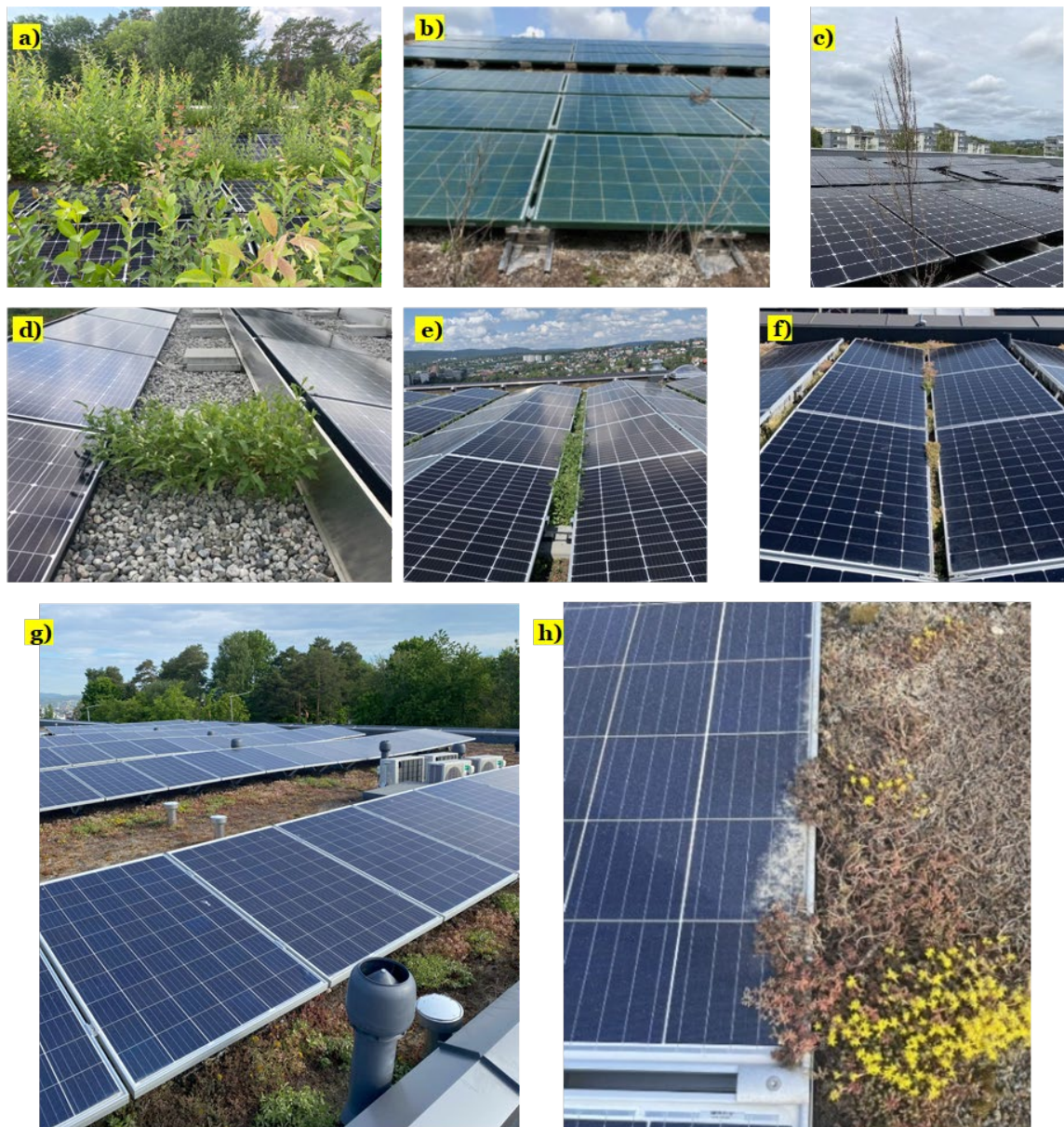
Figur 39. Eksempler på observert skygge fra vegetasjon på solcellepanel. A) Skygge fra høye planter/ugress (i stor grad), b) og c) Skygge fra høye planter/gress (i mindre grad). d) - f) Skygge fra vegetasjon (både sedum og ugress) på solcellepanel montert nærme taket. g) og h) solcellepanel på samme tak (Solfjellshøgda helsehus), men hvor g) panelene er hevet 38 cm over taket og har mindre skygge, og h) panelene er montert nærme taket og blir skygget. Foto: IFE.
