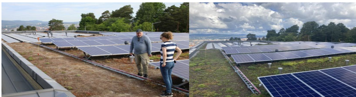
Figur 30. Solfjellshøga helsehus. Juni 2023 (til venstre) og august 2023 (til høyre). Foto: Lina M. Gunvaldsen/Over Easy Solar.
