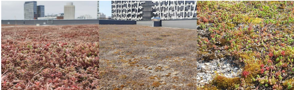
Figur 19. Løren skole. Mai 2022 (til venstre), mai 2023 (i midten) og mai 2023 (til høyre) under panelene. Foto: Lina M. Gunvaldsen/Over Easy Solar.
