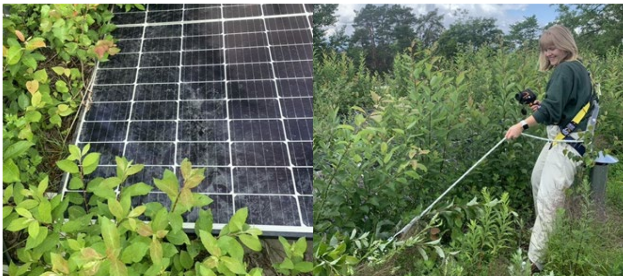
Figur 22. Munkerud miljøbarnehage. Solcellepanel dekket av pollen (til venstre) og koblingsvaier dekket av vegetasjon (til høyre). Foto: Lina M. Gunvaldsen/Over Easy Solar.
