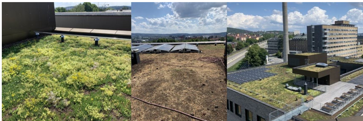
Figur 35. Storbylegevakten, juni 2023. Blomstring på det østlige taket (til venstre), tørkeskadet sedumdekke (i midten) og slitasje langs sti på det østlige taket fra plattingen, forbi panelene (til høyre). Foto: Lina M. Gunvaldsen/Over Easy Solar.
