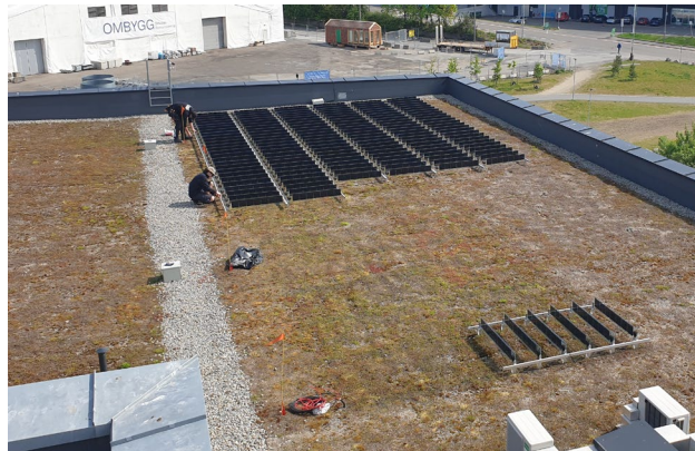
Figur 17. Løren skole. Fra luften er det mulig å se forskjellen på sedumlaget etter å ha flyttet solcellepanelene. Bildet er tatt mai 2023. Foto: Lina M. Gunvaldsen/Over Easy Solar.
