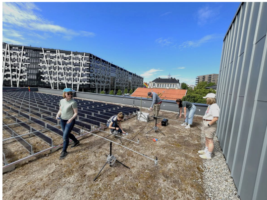
Figur 16. Løren skole. Montering av NIBIO sitt måleoppsett. Foto: Lina M. Gunvaldsen/Over Easy Solar.
