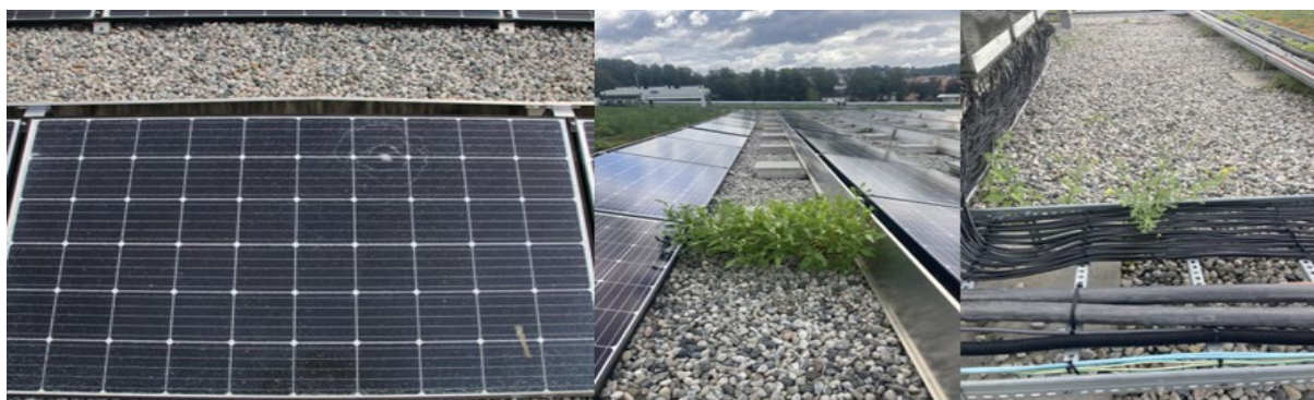
Figur 14. Jordal Amfi. Et knust panel (til venstre), skygge fra ugress (i midten) og ugressvekst i kabelbro (til høyre). Foto: Lina M. Gunvaldsen/Over Easy Solar.
