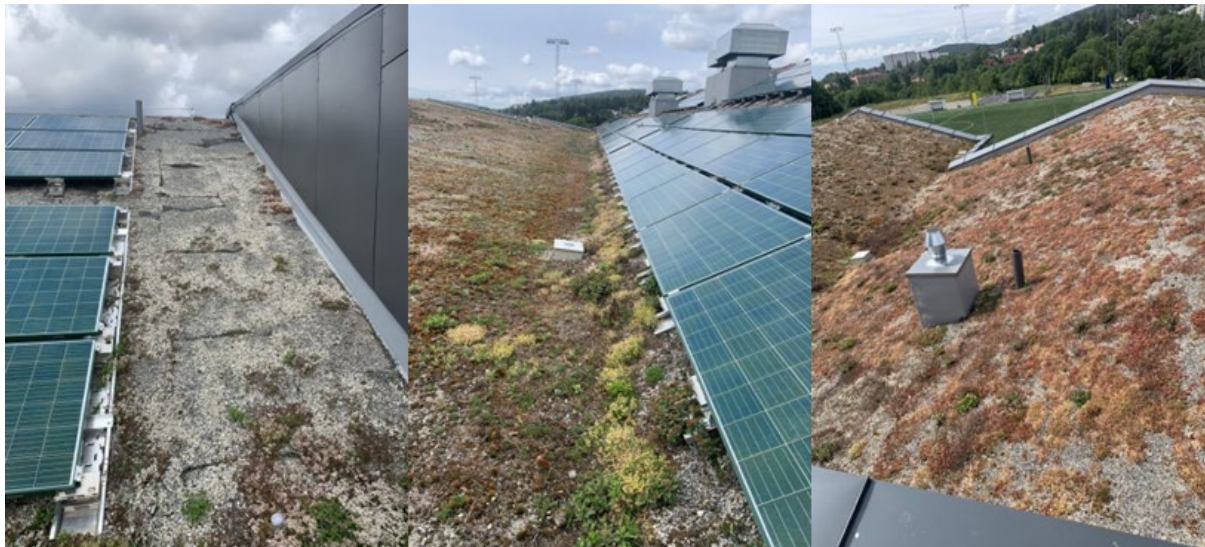
Figur 6. Grorud flerbrukshus, juni 2023. Eksponerte dreneringslag (til venstre), frodig sedum i takdalen (i midten) og sedumvekst vest på taket (til høyre). Foto: Lina M. Gunvaldsen/Over Easy Solar.
