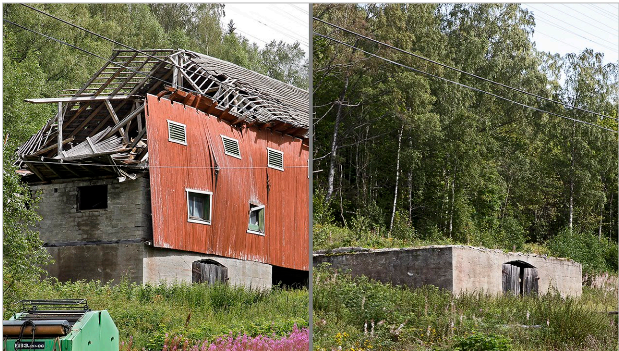
Bilde 8. Bygningsruiner er det landskapselementet med størst økning i antall nye forekomster. Det skyldes i stor grad at mange driftsbygninger som gikk helt ut av bruk på 1960 til 80-tallet nå står til forfall, og at eier på et visst tidspunkt velger å fjerne byggets rasfarlige deler. Som oftest står da selve grunnmuren igjen, hvilket blir registrert på 3Qs flybildetolkning i neste omdrev. Bildeparet fra 2015 – 2023 er fra Hjartdal kom., Telemark.
