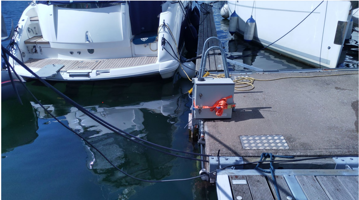
Figur 3. Stasjon SJØ-N på pir ut mot utløpet til Hoffselva. Overvåking er montert ved badestigen (Foto: Roger Roseth).
