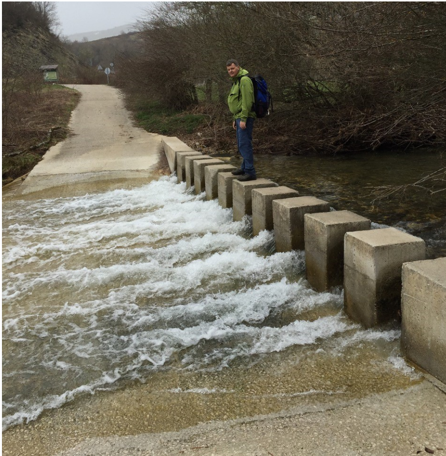
Figur 12. Senket og støpt flomvei over sti med støpte terskler for fremkommelighet i perioder med store vannmengder, eksempel fra Spania.
