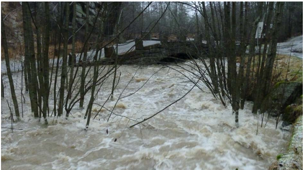
Figur 13. Flom ved steinhvelvbrua fotografert 27. desember 2020. De lavere delene av brua viser tegn til utglidning etter flommer. Kapasiteten ved storflom er nesten tatt helt ut og brua vil ved gjentatte slike episoder kunne ta skader som på sikt vil måtte innebære reparasjonsarbeider. Foto: Lars Juul.
